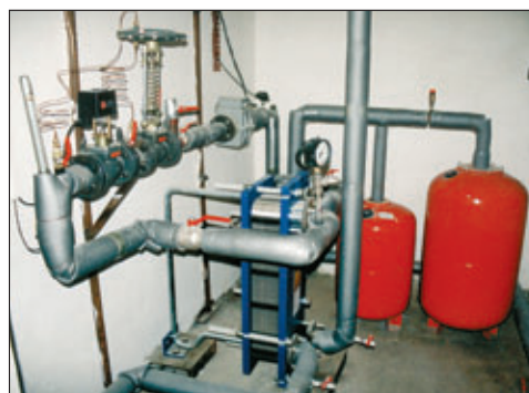
Рис. 41. Автоматизированный тепловой пункт.
