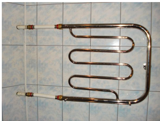
Рисунок 4: Новый ПС, являющийся частью стояка, безграмотная замена.
