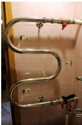
Рисунок 6: Новый ПС, являющийся частью стояка, абсолютно безграмотная замена.
