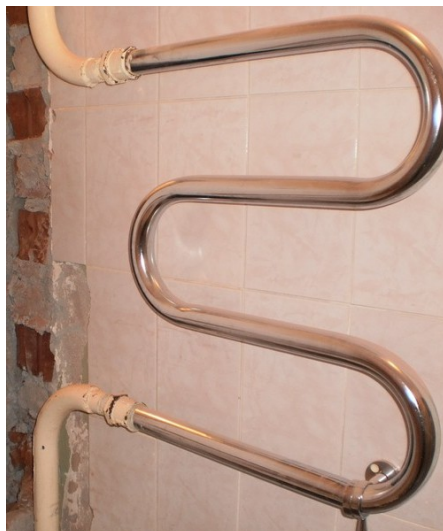
Рисунок 3: Новый ПС, являющийся частью стояка, грамотная замена.
