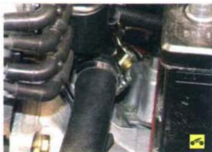
6. ...и с водораспределительной трубой
