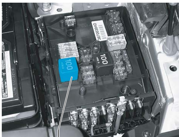
Реле дополнительного насоса системы охлаждения J496
